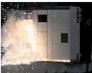
Обычные системы защит не обеспечивают быстрой защиты от дуговых замыканий.
