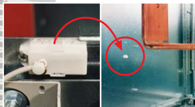
Der Punktsensor überwacht den Geräte-raum durch ein Loch in der Gehäusewand.
