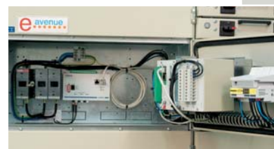
Die Slavemodule werden in den Geräträumen der Schaltanlage positioniert. Die Verbindung zur Zentraleinheit wird mit einer vorkonfigurierten Verbindungsleitung hergestellt.
